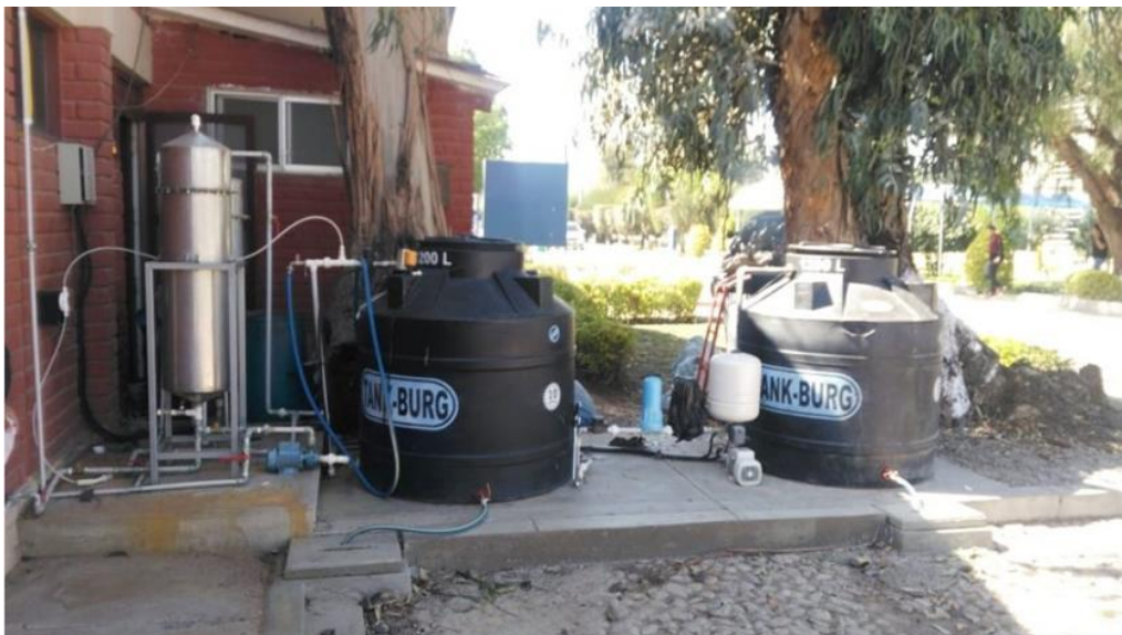
Figura 9: Sistema de tratamiento de aguas con contenido de arsénico en Cochabamba.
