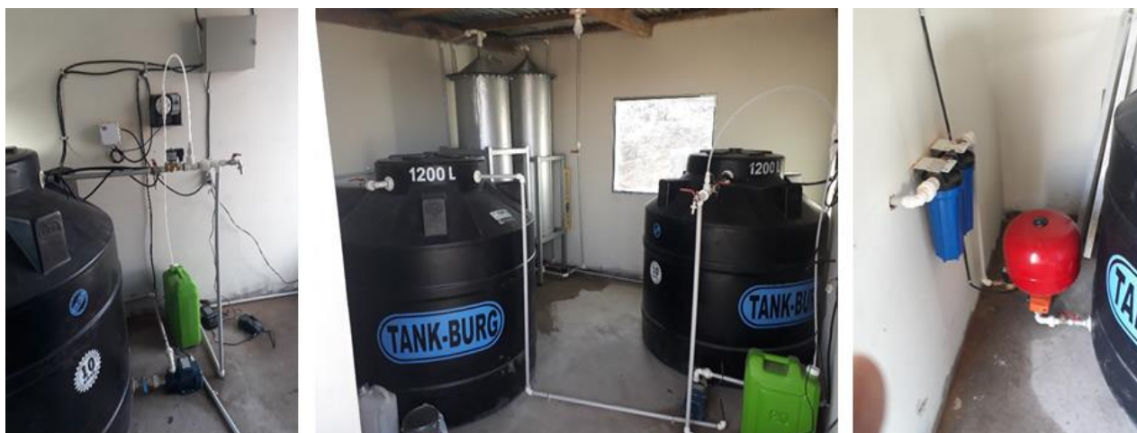
Figura 11: Sistema de tratamiento de aguas con contenido de arsénico en Quillacas.
