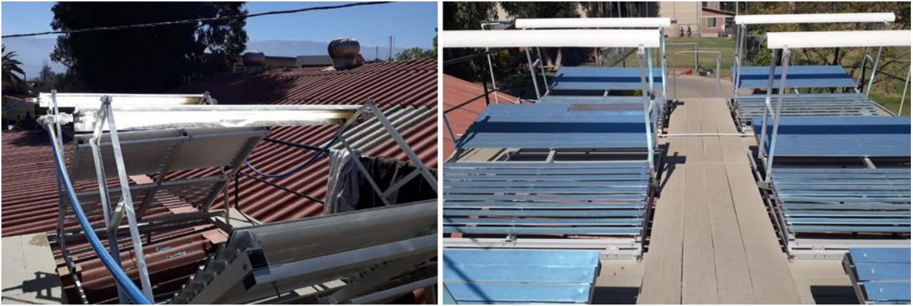
Figura 8: Sistema de foto-colectores solares del tipo Fresnel instalados en Cochabamba.
