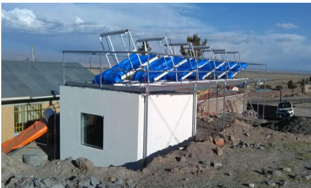
Figura 10: Sistema de foto-colectores solares del tipo Fresnel instalados en Quillacas.
